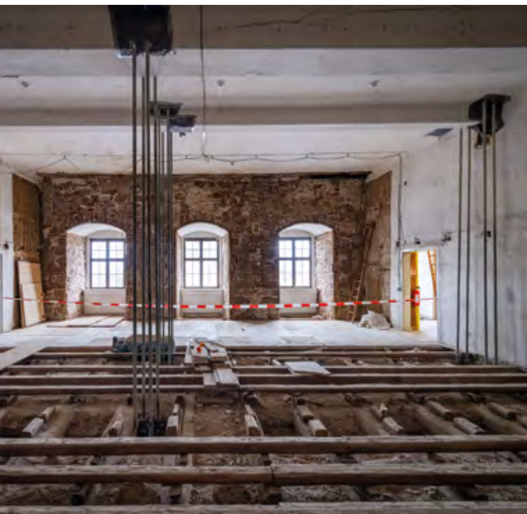
Sanierungsbedürftige Baukonstruktion im Ostturm
