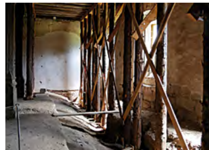
Kloster Veßra, Refektorium mit Sanierungsbedarf
