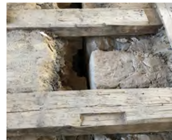
Spannende Baubefunde, freigelegt unter einem Dielenboden
