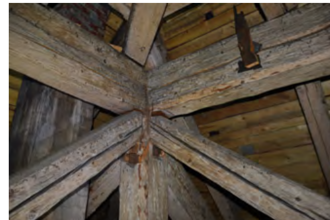
Marode Holzkonstruktionen im Orangeriehaus
