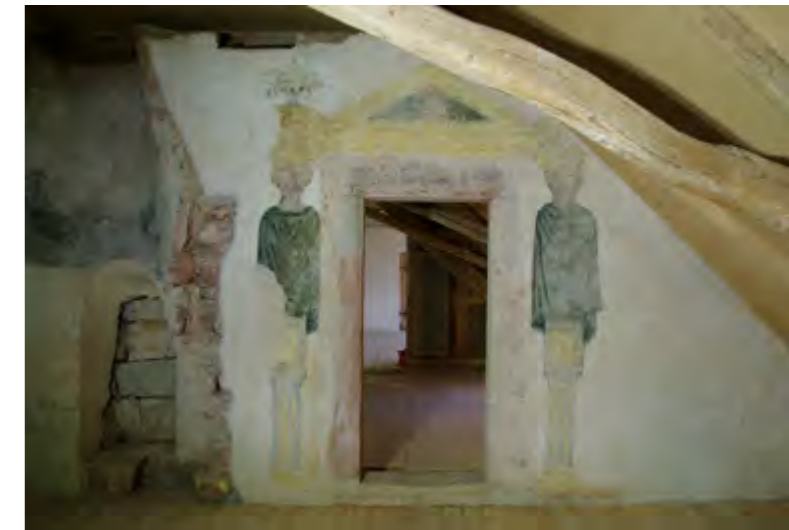
Konserviertes Wandmalereifragment im Dachgeschoss des Nordflügels
