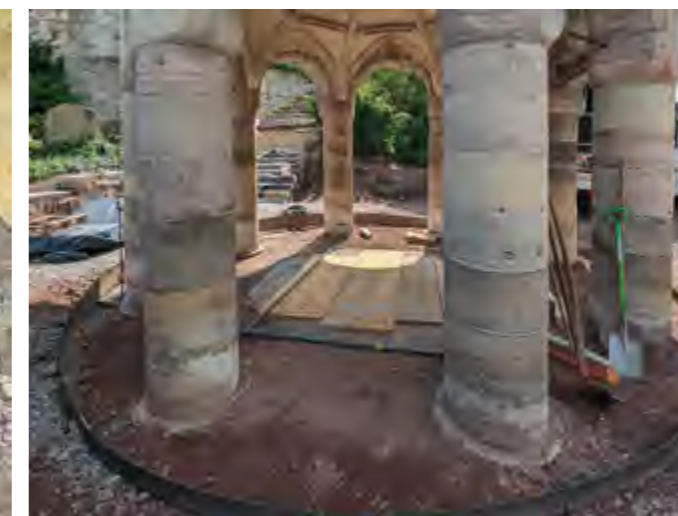
Brunnenhaus mit abgedeckter Brunnenstube
