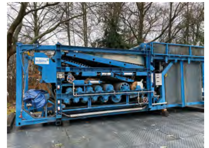
Entwässerungsanlage im Fürstlich Greizer Park
