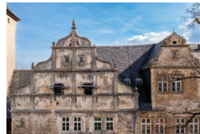
Notgesicherter Giebel an der Westfassade
