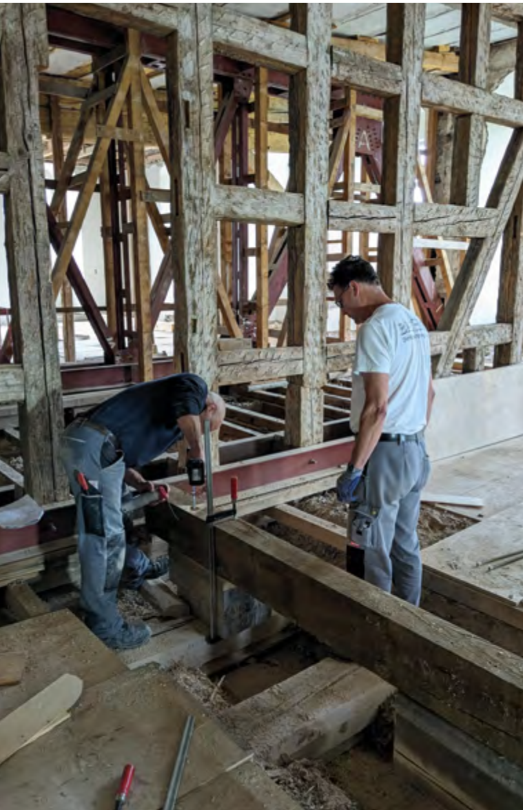
Notsicherungen im Westturm
