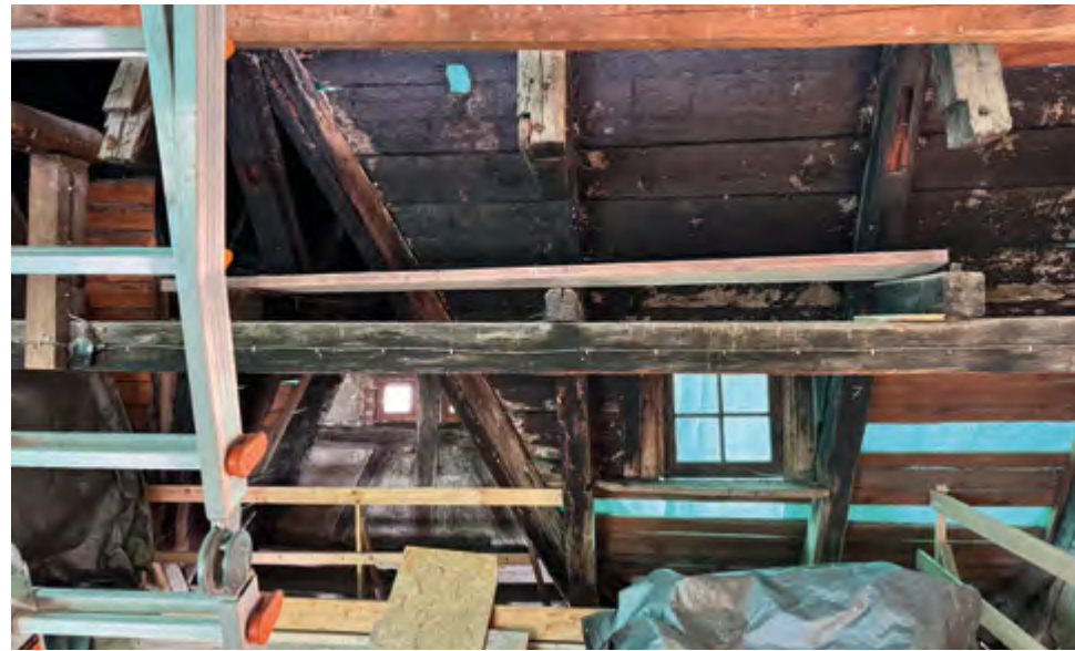
Verrußte Stelle im historischen Dachstuhl
