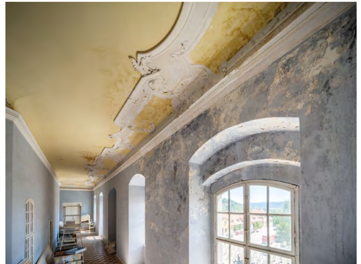
Galerie mit Feuchtigkeitsschäden im zweiten Obergeschoss des Westflügels
