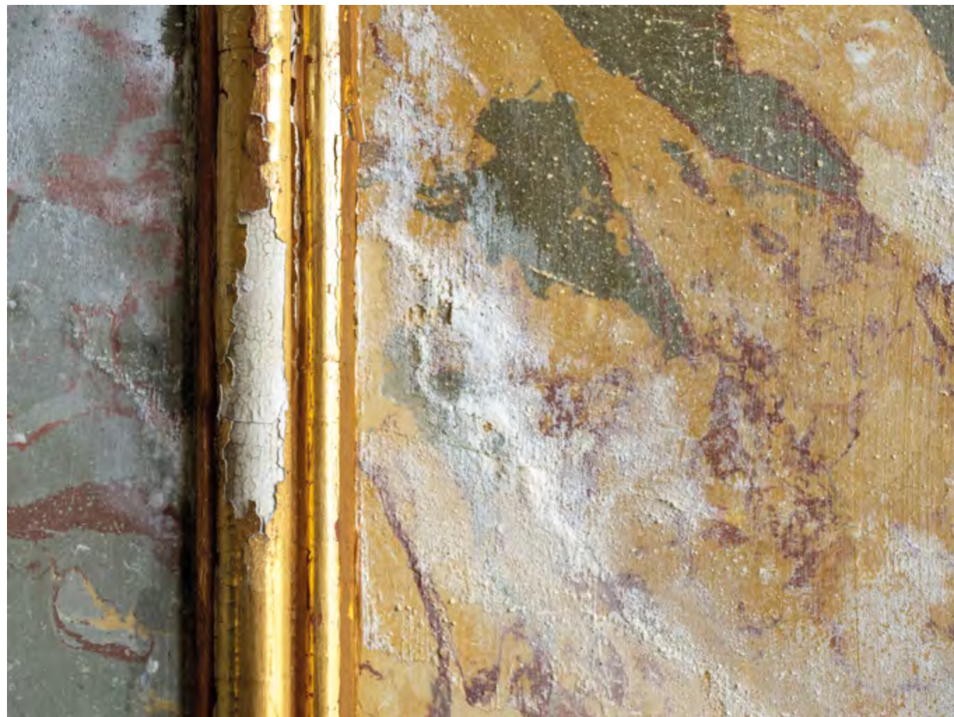
Abplatzungen und Versalzungen an einer Wand des Festsaals
