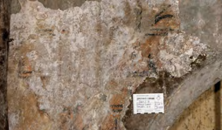
Neben konstruktiven Schäden wurden bei den Voruntersuchungen im Torhaus der Burg Ranis auch Wandmalereifragmente entdeckt.
