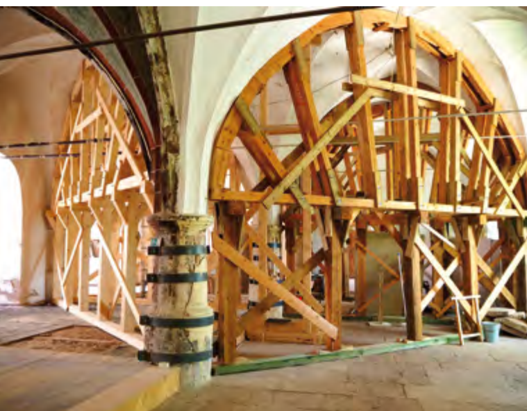
Das durch Alter, Umbauten und Bodensetzungen geschädigte statische Gefüge der Alten Flügel von Schloss Sondershausen soll im SIP I dauerhaft gesichert werden. Seit Jahrzehnten geben Notsicherungen provisorischen Halt in der ehemaligen Bergbauregion.
