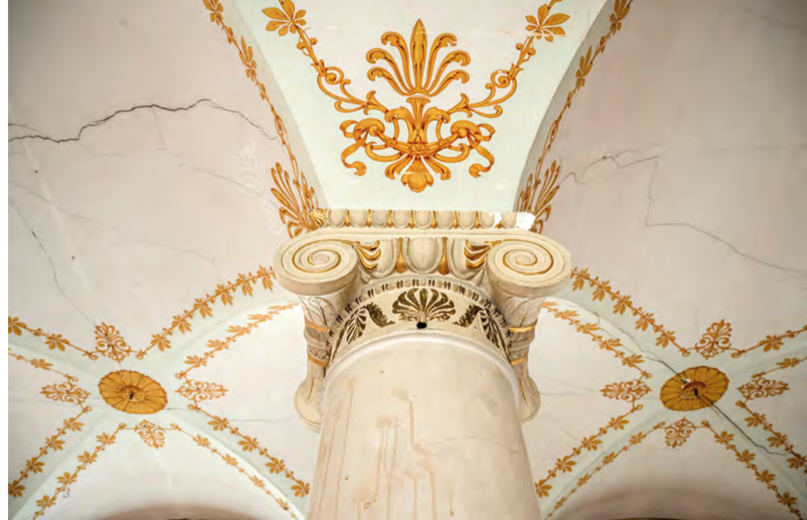
Risse im Gewölbe der Säulensäle von Schloss Heidecksburg, verursacht durch statische Schäden.
