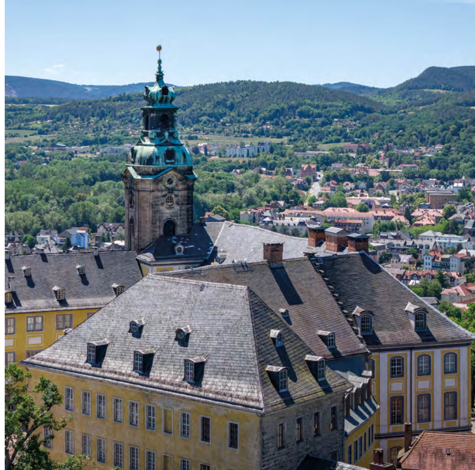
Die verschachtelte Dachlandschaft mit Feuchte- und Statikschäden am Nord- und Westflügel von Schloss Heidecksburg wird im Rahmen des SIP I saniert.
