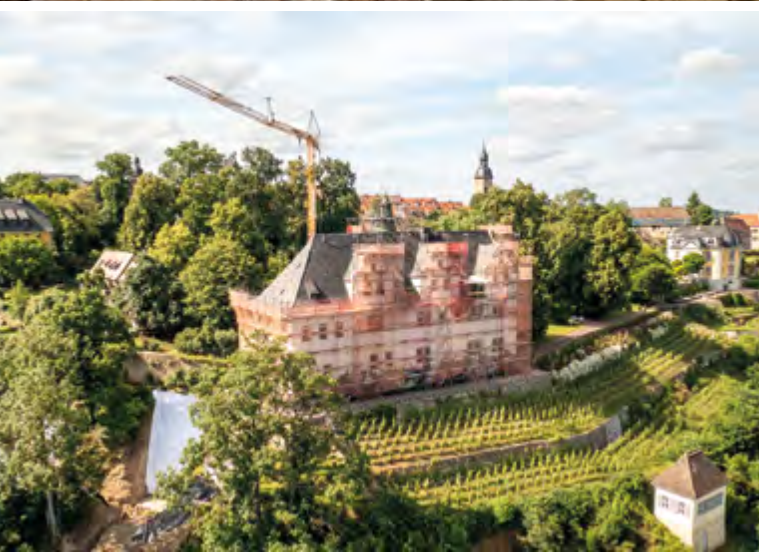
Im Dach des Renaissanceschlusses auf den Dornburger Schlössern bröseln die Balken, konstruktive Verbindungen müssen wiederhergestellt werden.
