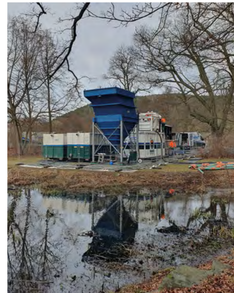
Aufbereitungsanlage am Seeufer
