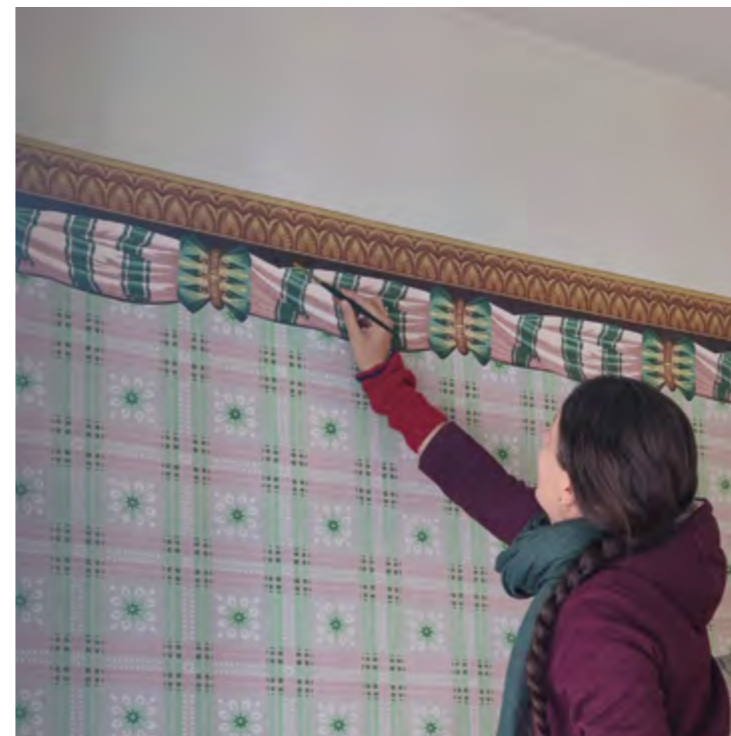
Tapetensicherung im Kirms-Krackow-Haus
