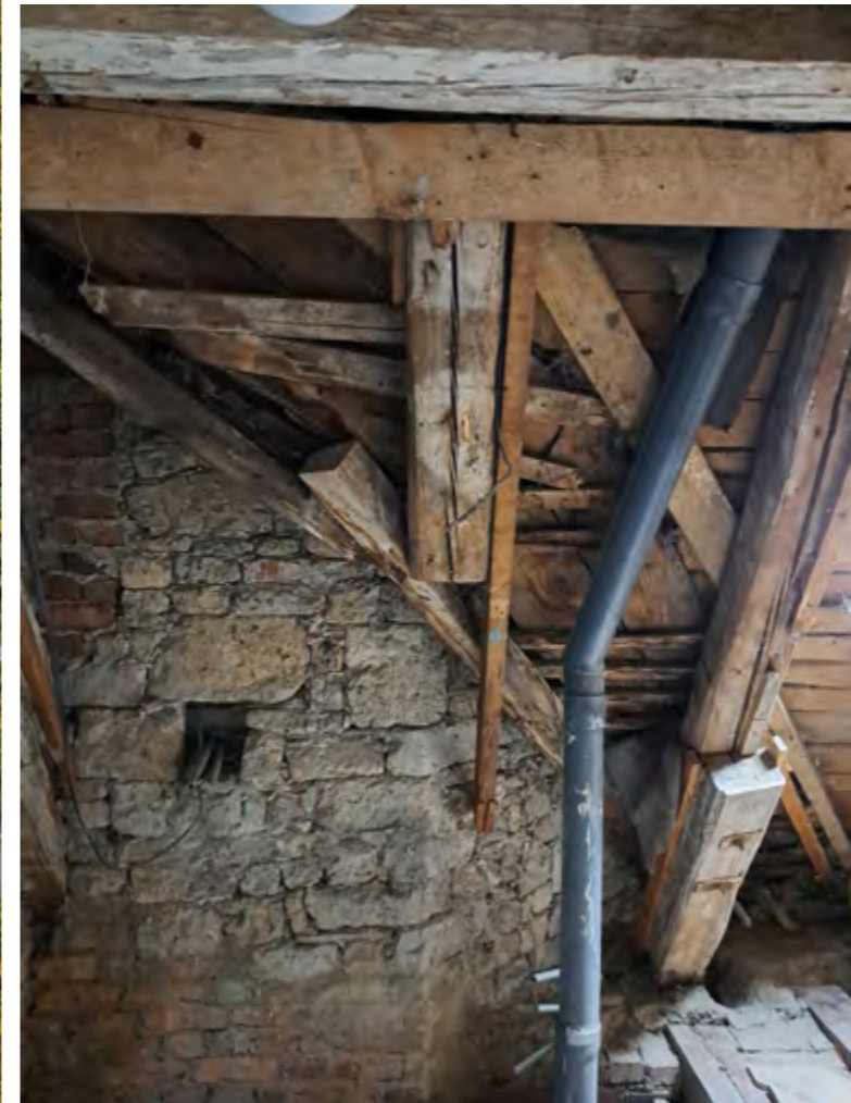
Schaden an der Dachkonstruktion
